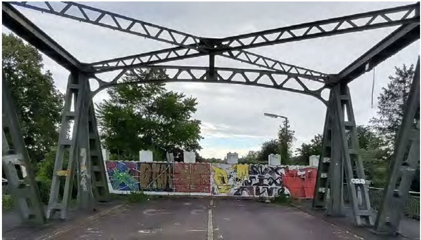
Heute ist die Brücke an beiden Einfahrten mit einer Mauer und einem davorstehenden Stabmattenzaun gegen Benutzung gesperrt. Auf Neuköllner Seite ist allerdings ein Einstieg in den Zaun geschnitten. (Foto Morsbach)
